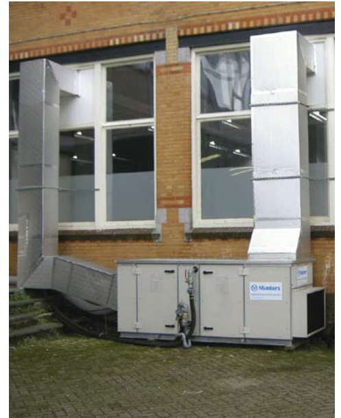
An HVAC unit in situ.
